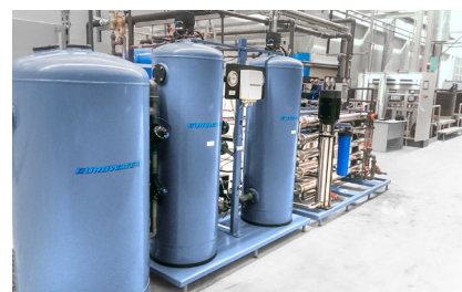
Filtr z węglem aktywnym przed zmiękczeniem i dwupasową RO u producenta części samochodowych w Rosji.
