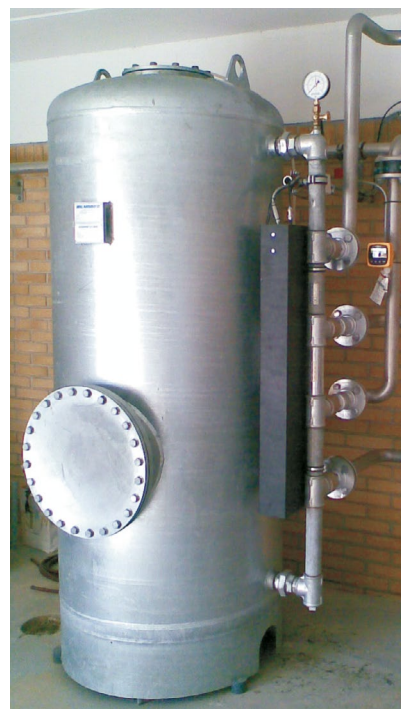
Usuwanie arsenu za pomocą adsorpcji w stacji wodociągowej. Rozwiązanie składa się z automatycznego filtra ciśnieniowego typu NSB 170 zainstalowanego na wylocie z filtrów otwartych. Przepływ: 12 m 3 /h.
